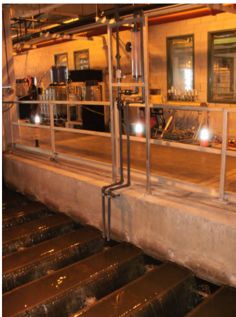
FIGURE 3.17 – Système d’injection du polymère, photographie d’un des cinq points d’injection situé à la sortie d’un dessableur.
