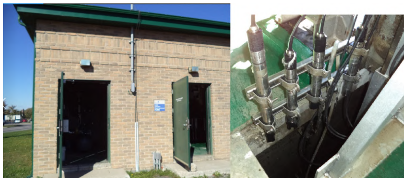
FIGURE 3.4 – Chambre de contrôle du BR de Saint-Sacrement (à gauche) et localisation où l'échantillonneur et les capteurs ont été installés (à droite).
