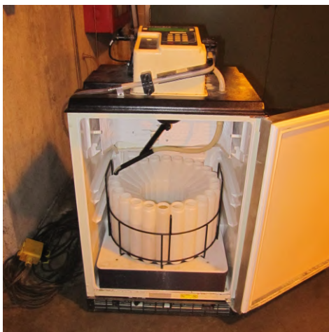
FIGURE 3.7 – Échantillonneur automatique réfrigéré de type SIGMA SD 900, installé à l'entrée des décanteurs primaires à la StaRRE Est de la Ville de Québec.
