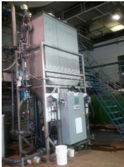
Figure 3 : Le décanteur pilote
